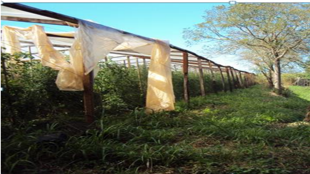
Figura 32. Estrutura para cultivo protegido, prejudicado por ação de ventos.
