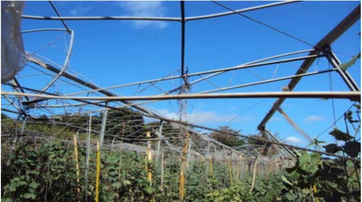
Figura 33. Estrutura metálica para cultivo protegido, destruição por vendaval.
