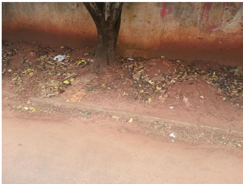
Figura 10 - Calçada sem acessibilidade na Rua Prof. a Maria E. Barbosa, em Jardim Universitário
