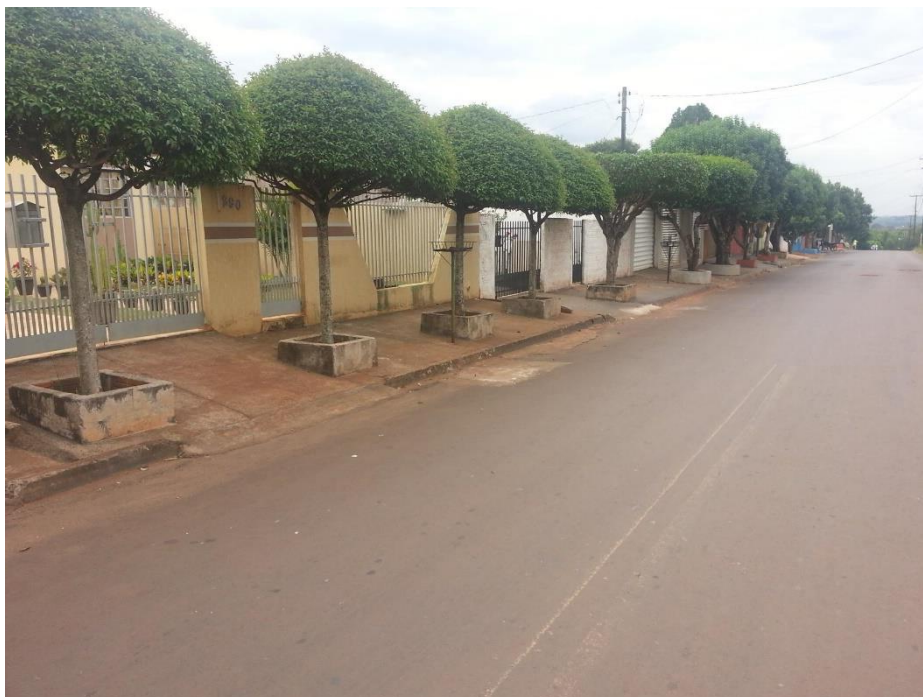
Figura 8 - Calçada sem acessibilidade na Rua Prof. a Sinclair Sambati, em Jardim Universitário
