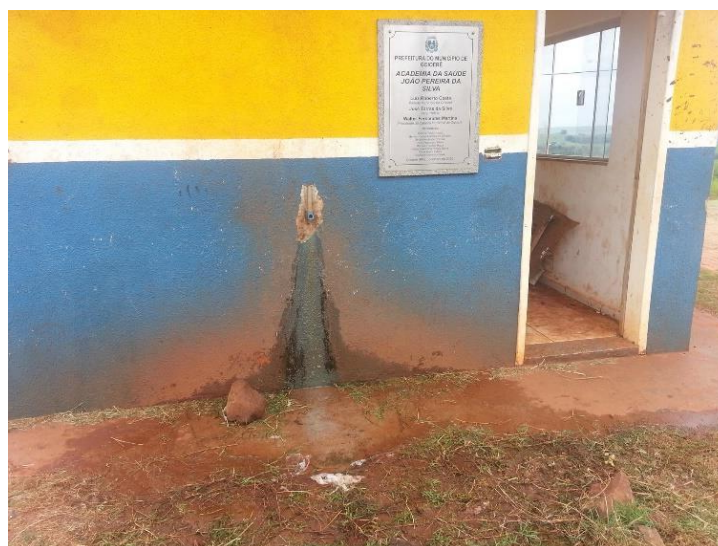
Figura 6 - Local do Espaço Saúde sem a manutenção devida e com depredação
